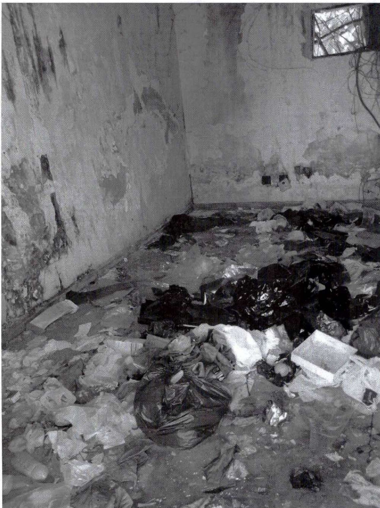
Foto 06 – Descrição: Evidência de queima e risco de incêndio.
