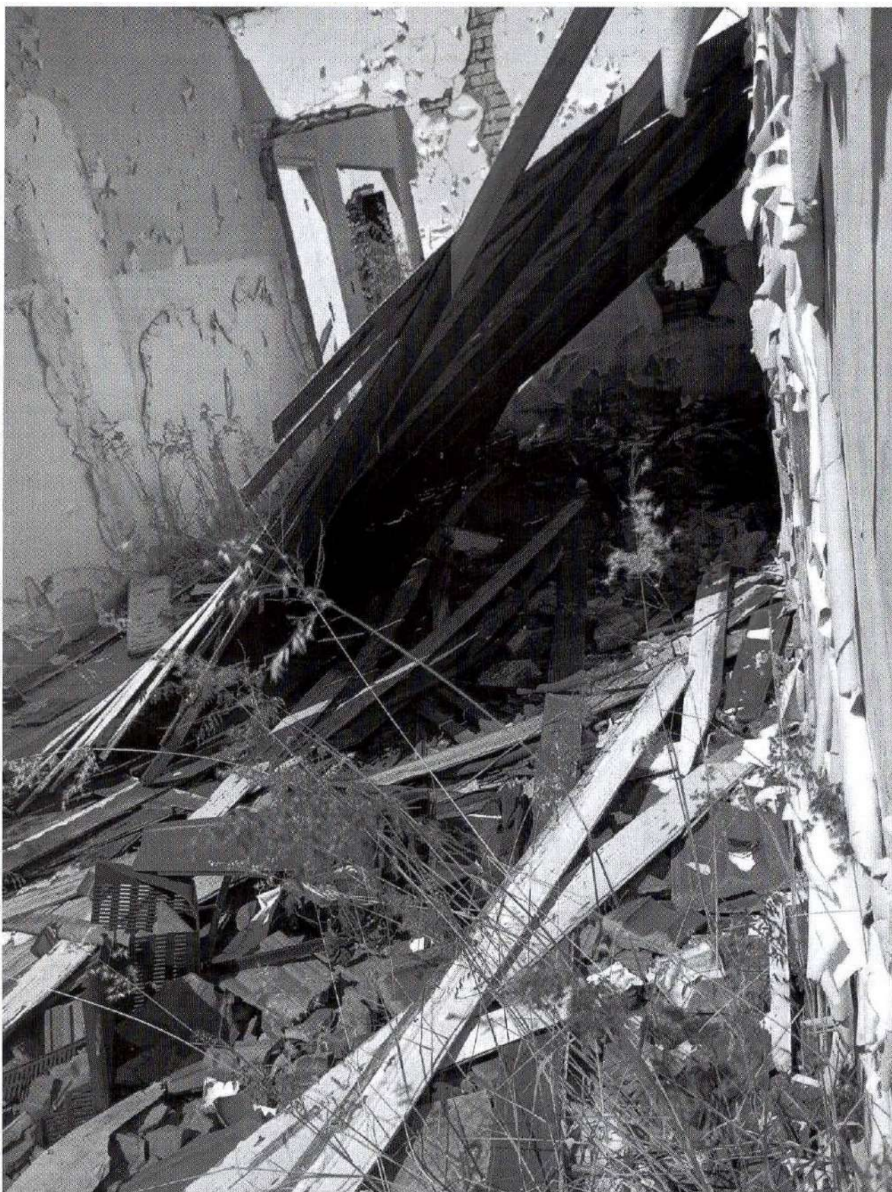
Foto 04 – Descrição: Estruturas abandonadas e risco de acidentes.
