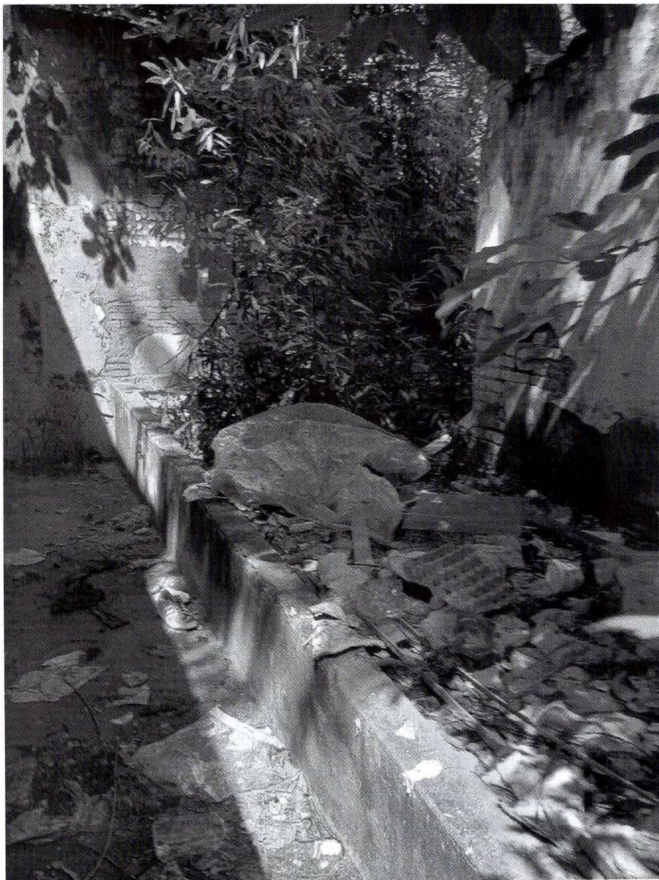
Foto 02 – Descrição: Acúmulo de resíduos e vegetação alta.
